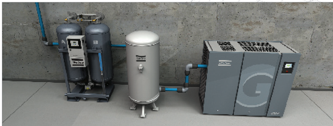
Secador CD instalado com a opção de tubagem invertida.
