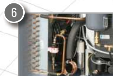
6 Secador de ar comprimido por refrigeração
